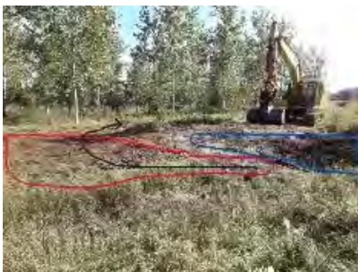
passage busé – en bleu, la nouvelle digue – en rouge, la zone de débordement – flèche noire, sens de circulation de l'eau
