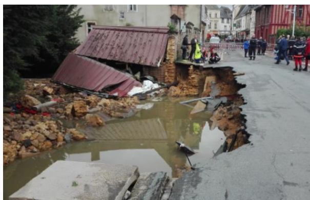
Figure 38 – Inondations observées à Bonnétable en juin 2018
